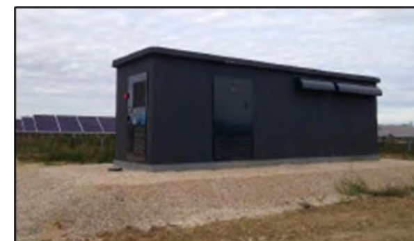
Exemple de poste électrique (livraison et transformation)
